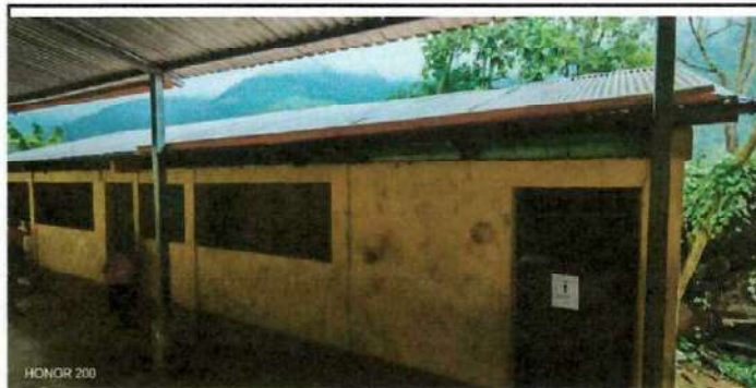
Foto 4: la pintura de los modulos 3 y 4 estan manchado, por que es necesario pintarlo
