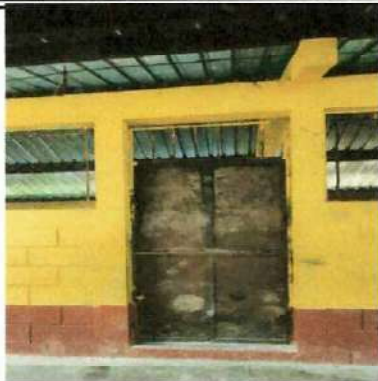
Foto 1: la puesta del aula segundo y cuarto primaria. Esta deteriorado. Y es necesario sustituirlo
