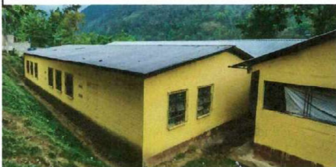
Foto 3: La estructura del entechado de los modulos 2 3 ya estan deteriorado, por que es necesario sustituirlo
